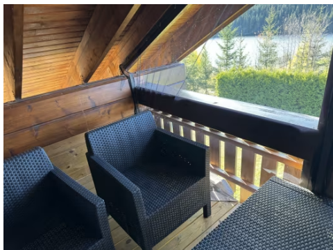
Krav til rekkverkshøyde er 100 cm. Høyere rekkverk må etableres for å lukke avviket.
