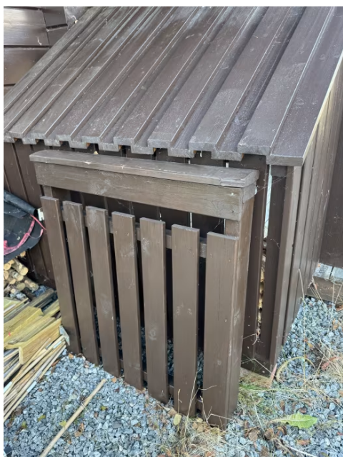
Ny grind er laget til markterrasse, ikke montert på befaringdagen.
