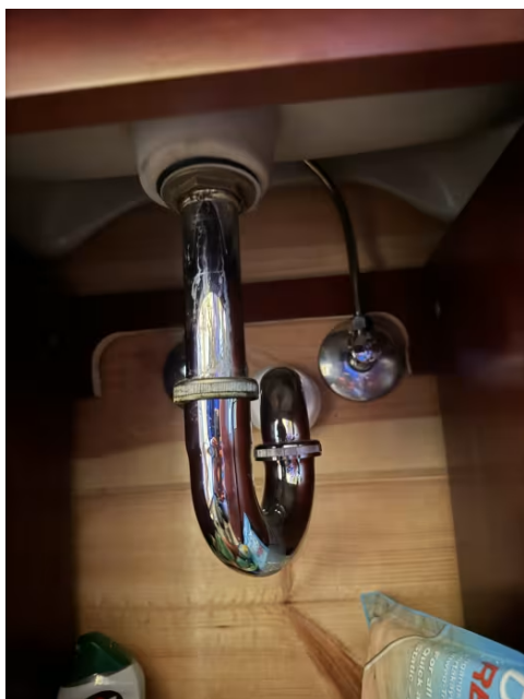
Avløp i metall under vask på bad
