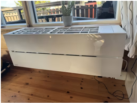
Varmepumpe plassert ved spisestue/kjøkken.
