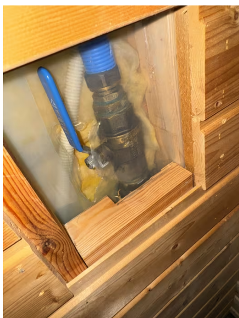
Stoppekran plassert i luke i badstue.
