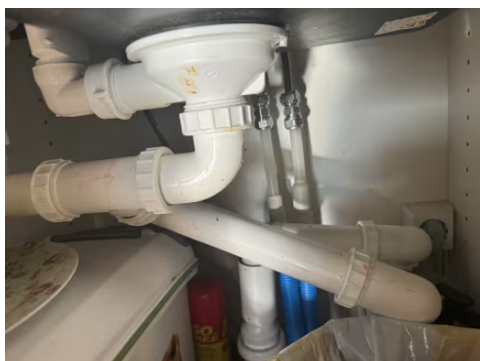
Avløp i plast på kjøkken
