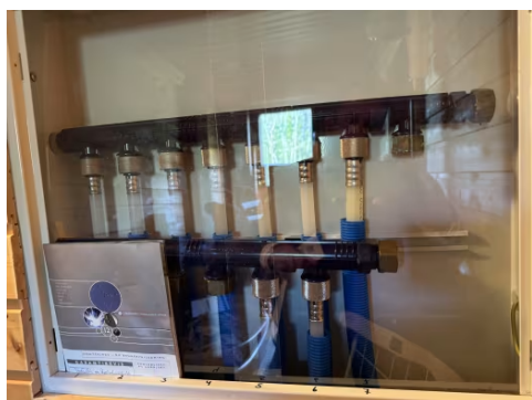
Fordelerskap plassert på badstue
