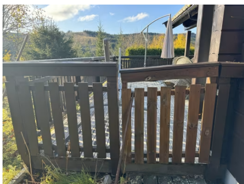
Grind på markterrasse er skjev og skal byttes iflg eier.
