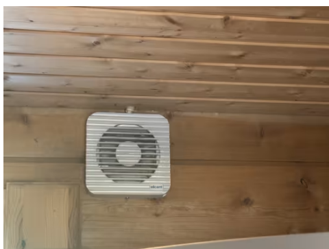
Avtrekksvifte mot yttervegg
