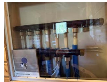
Fordelerskap plassert på badstue
