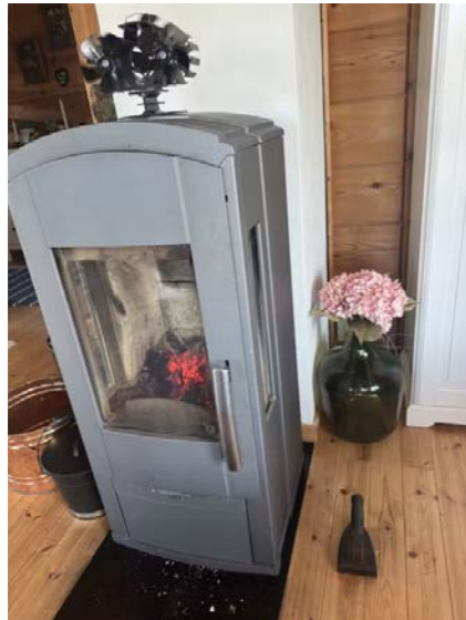
Vedovn med glassdør plassert i stue.
