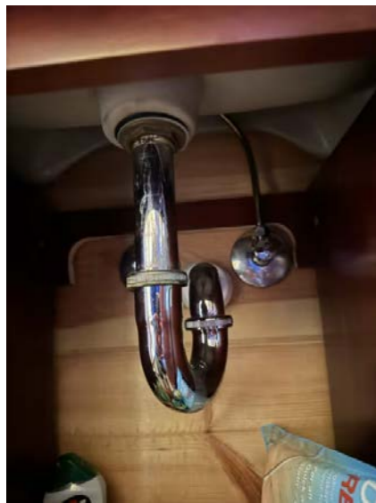
Avløp i metall under vask på bad
