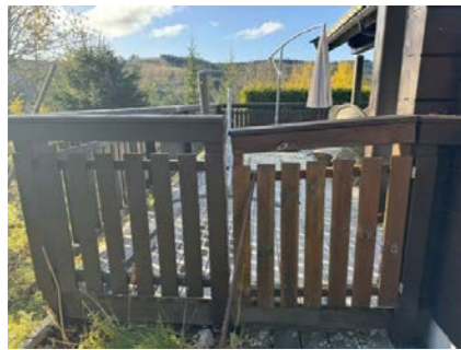
Grind på markterrasse er skjev og skal byttes iflg eier.
