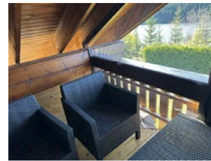
Krav til rekkverkshøyde er 100 cm. Høyere rekkverk må etableres for å lukke avviket.
