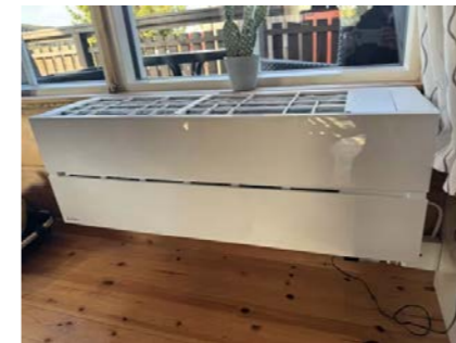
Varmepumpe plassert ved spisestue/kjøkken.
