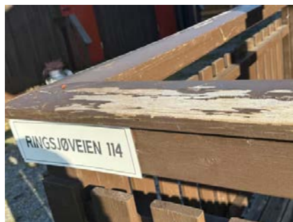
Overflatebehandling må påregnes
