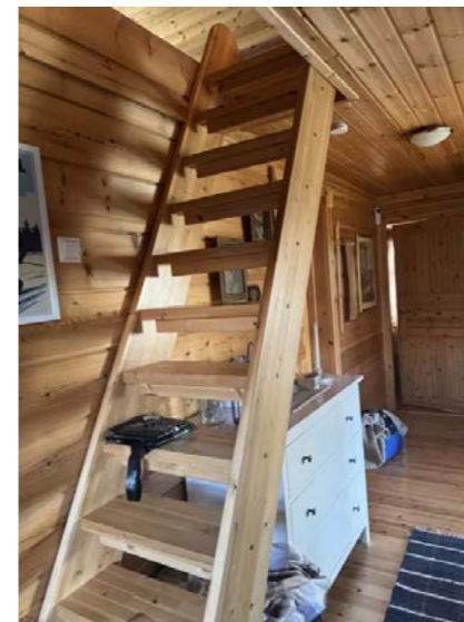
Bratt trapp uten rekkverk.
