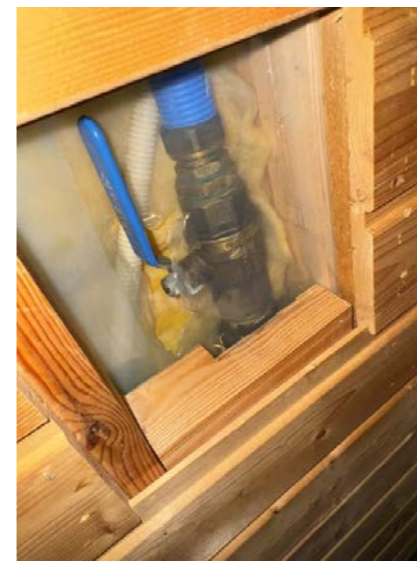
Stoppekran plassert i luke i badstue.
