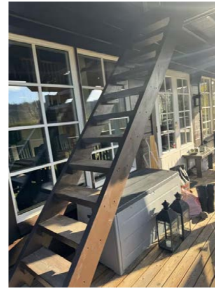
Trapp opp til 2. etg utvendig mangler rekkverk og håndløper.
