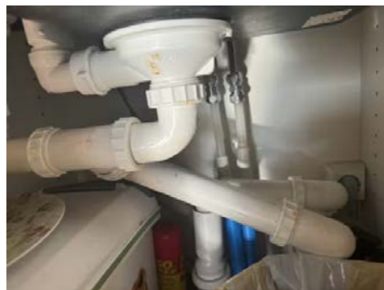
Avløp i plast på kjøkken
