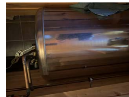
Liggende bereder plassert i badsstue
