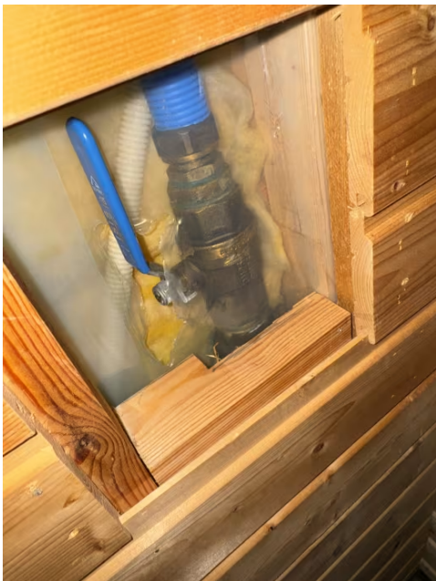
Stoppekran plassert i luke i badstue.
