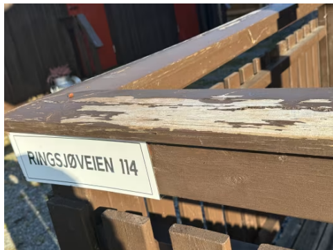
Overflatebehandling må påregnes
