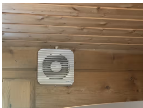
Avtrekksvifte mot yttervegg
