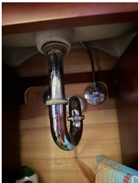
Avløp i metall under vask på bad
