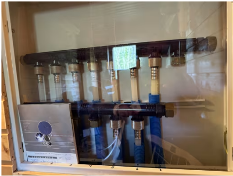
Fordelerskap plassert på badstue
