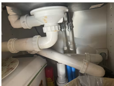
Avløp i plast på kjøkken
