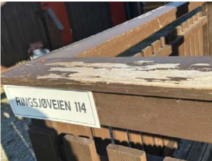
Overflatebehandling må påregnes
