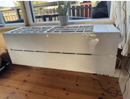
Varmepumpe plassert ved spisestue/kjøkken.
