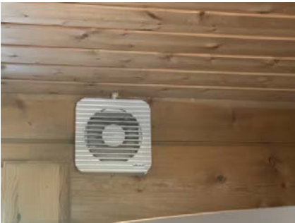
Avtrekksvifte mot yttervegg
