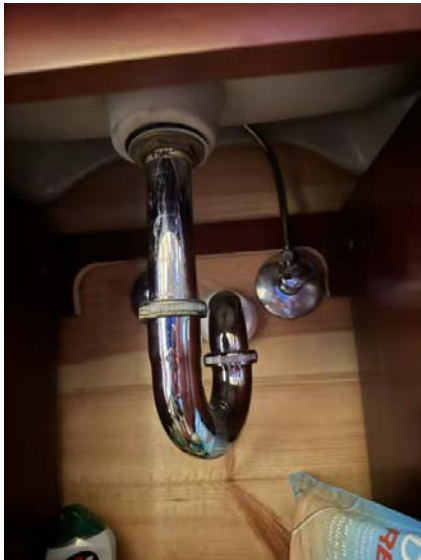
Avløp i metall under vask på bad
