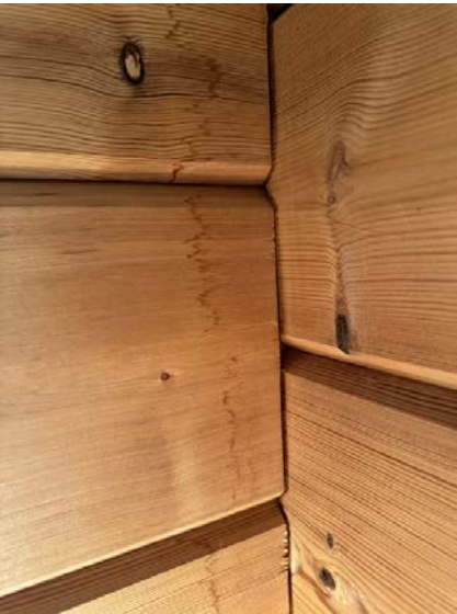
Det registreres gamle fuktmerker etter vanninntrengning i hjørne i stue mot terrasse og vegg ved kjøkken/varmpumpe. Det opplyses at dette var der da eier overtok hytta for ca 12 år siden.
