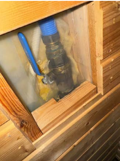
Stoppekran plassert i luke i badstue.
