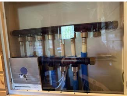
Fordelerskap plassert på badstue
