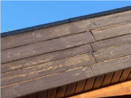
Overflatebehandling må påregnes på fasader.
