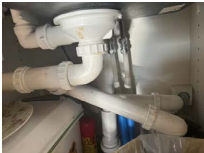
Avløp i plast på kjøkken
