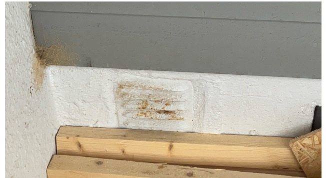
Rust på ventil deksel.
