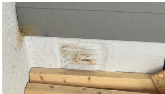
Rust på ventil deksel.
