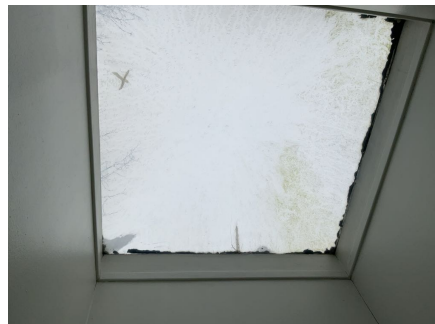
Sprekk i glassfelt / kuppel, i tilknytning til takvindu.
