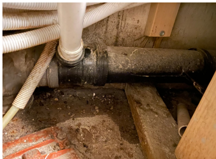
Fargesymptomtomer på fuktvandring - innvendig veggfot
