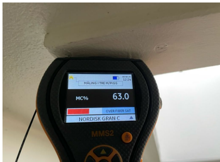
Høyt trefuktinnhold i innvendig karmlist under takvindu.
