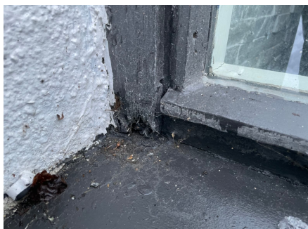
Påbegynt råte i vindusbelistning.
