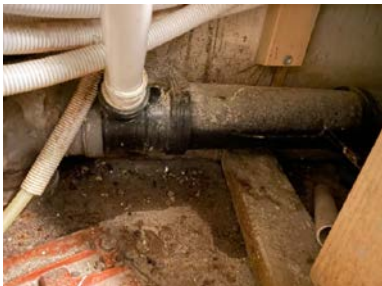
Fargesymptomtomer på fuktvandring - innvendig veggfot
