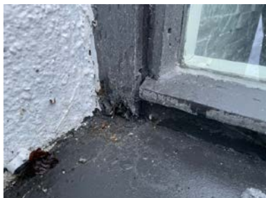
Påbegynt råte i vindusbelistning.
