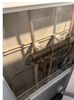
Selger har montert sprutplate i vannfordelingskap etter befaringen for å ivareta vannsikkerheten.
