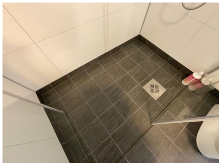
Gulv i dusj er nedsenket
