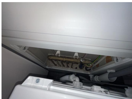
Vannfordelingskap er plassert bak vaskemaskin
