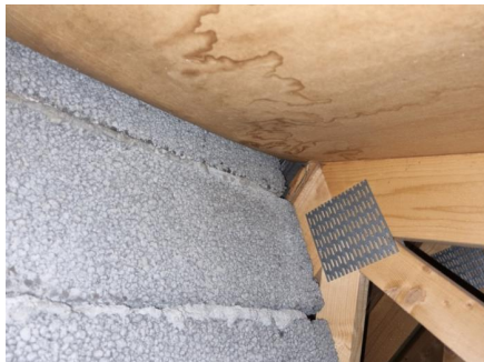
Noe fuktmerker ved gjennomføring til pipe
