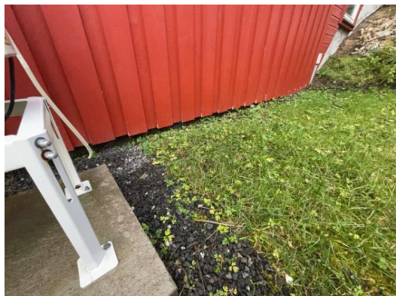
Synlig grunnmursplast ved underetasje
