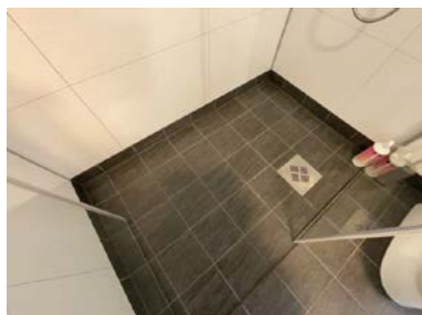
Gulv i dusj er nedsenket
