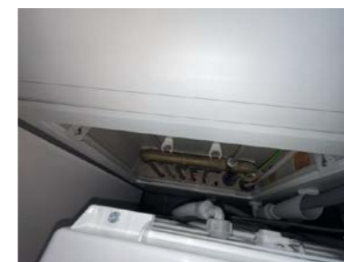
Vannfordelingsskap er plassert bak vaskemaskin
