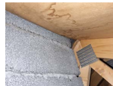
Noe fuktmerker ved gjennomføring til pipe
