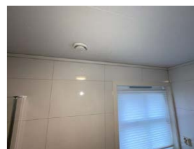
Mekanisk avtrekk i himling og åpningsvindu med ventil
