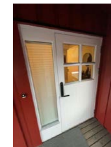
Hoveddør fra byggeår med smartlås fra 2020.
