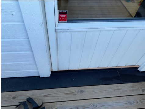
Utvendig værslitasje på terrassedør.
