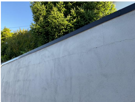
Riss/sprekker i støttemur.
