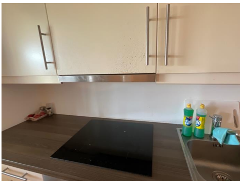
Krakelering på skapdør.
