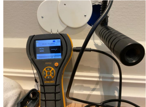
Fuktmåling i vegg under bakkenivå
