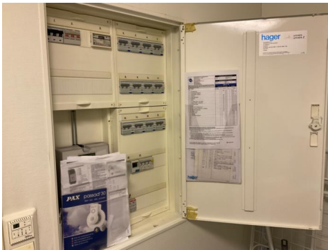
Sikringskap i bolig
