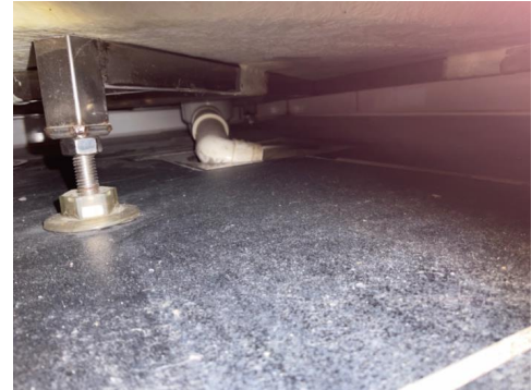
Sluk under dusjkabinett
