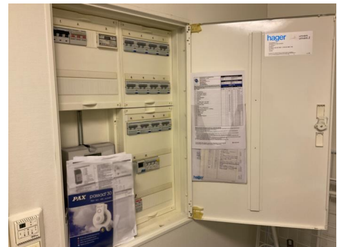
Sikringskap i bolig
