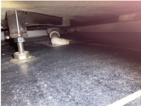
Sluk under dusjkabinett
