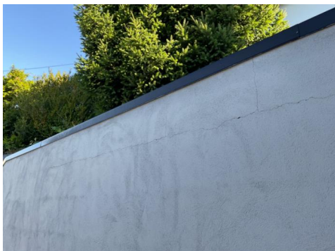
Riss/sprekker i støttemur.
