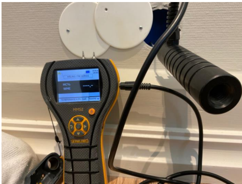
Fuktmåling i vegg under bakkenivå
