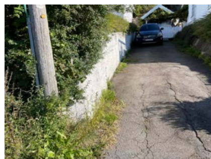
Gammel støttemur mot nabo.
