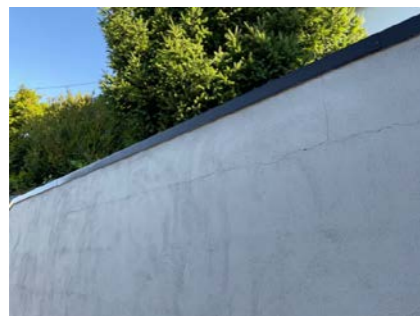
Riss/sprekker i støttemur.
