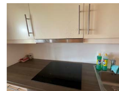
Krakelering på skapdør.
