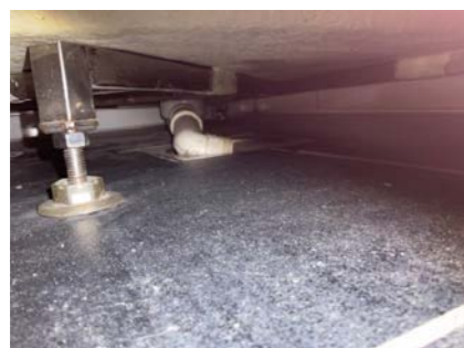
Sluk under dusjkabinett
