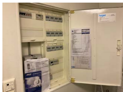
Sikringskap i bolig
