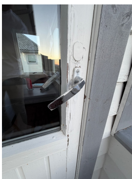
Døren bør skrapes og overflate behandles
