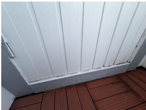
Døren bør skrapes og overflate behandles
