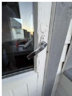
Døren bør skrapes og overflate behandles
