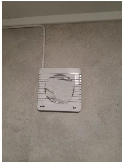
Avtrekkseffekt er testet med papir.
