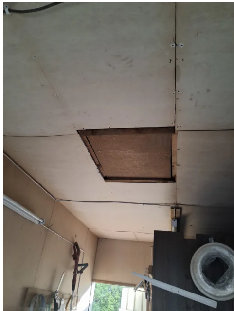
Kaldtloft ble ikke inspisert av sikkerhetsmessige årsaker.
