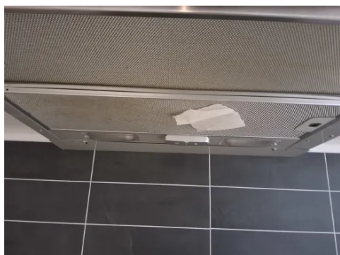
Avtrekkseffekt er testet med papir.
