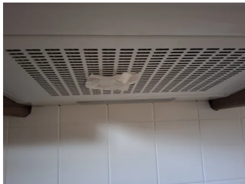
Avtrekkseffekt er testet med papir.
