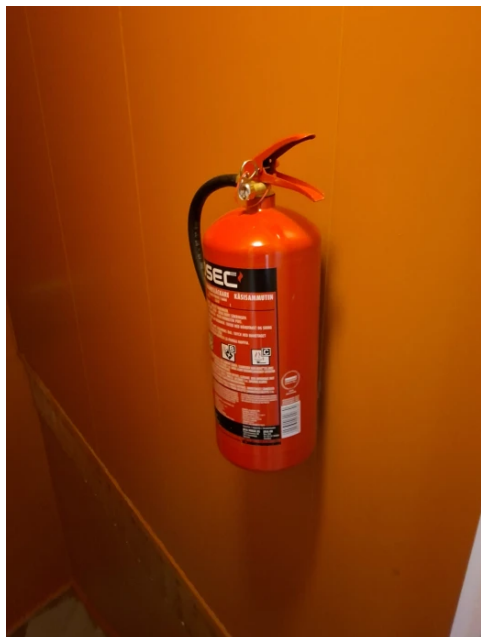
Vegghengt brannslukningsapparat i trappegang.
