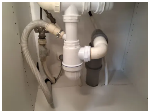
Boligen har synlige avløpsrør av plast.
