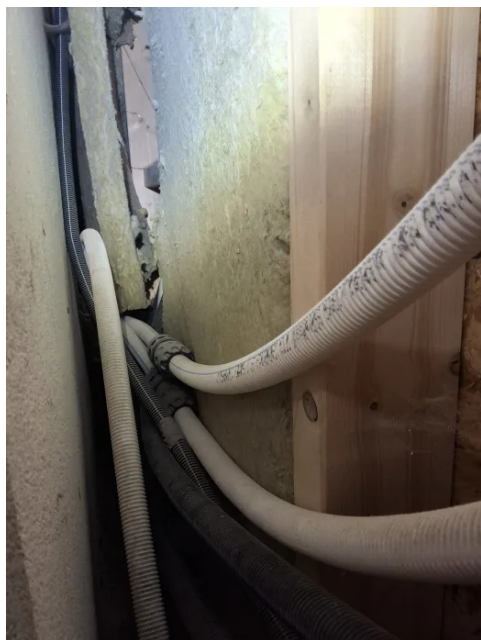
Mangelfull klamring av vannrør, og skjøtepunkter er lite tilgjengelig for kontroll.
