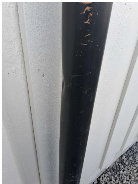
Det registreres enkelte nedløpsrør med bulker.
