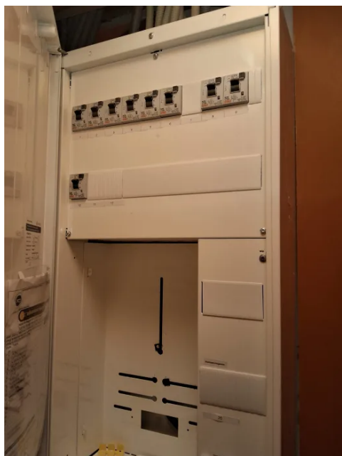
Sikringsskap er plassert i bod under trapp.
