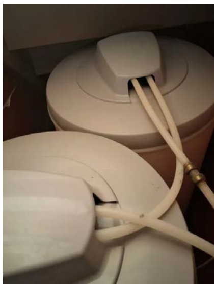
Vannrør av plast er koblet direkte på berederene.
