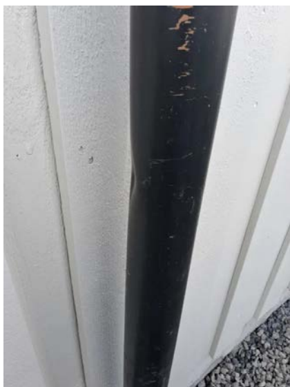
Det registreres enkelte nedløpsrør med bulker.
