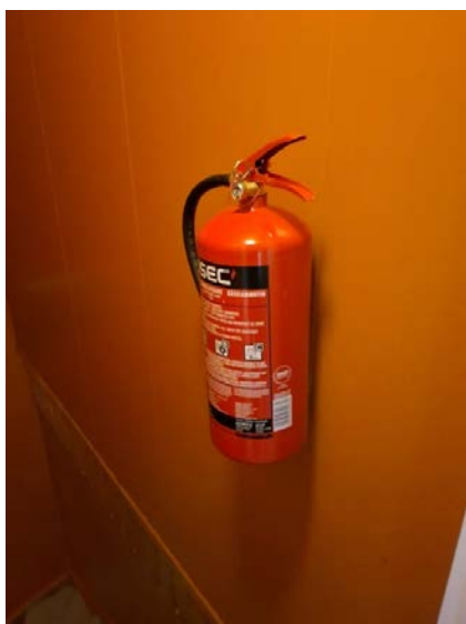
Vegghengt brannslukningsapparat i trappegang.
