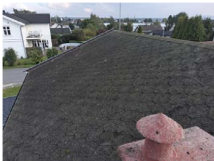
Enkelte takflater er mosegrodd.
