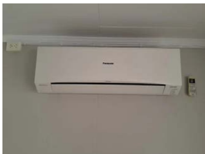
Varmepumpe er montert i stue.
