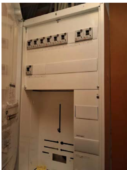
Sikringsskap er plassert i bod under trapp.
