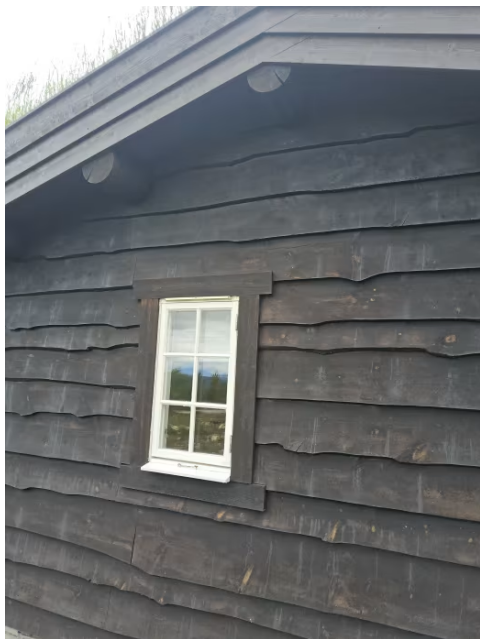
Bilde viser vindu uten vannbrett.
