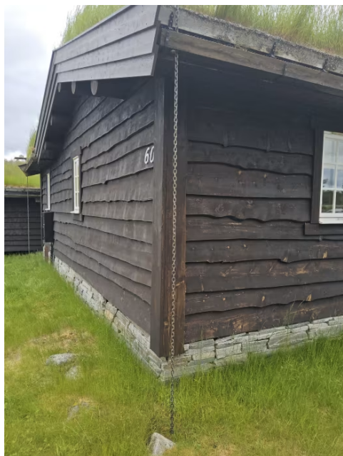
Bilde viser kjettingnedløp.
