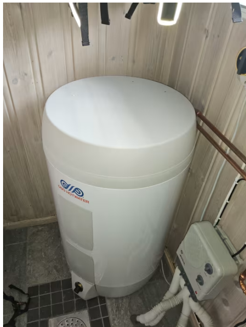
Bilde viser varmtvannsbereder.
