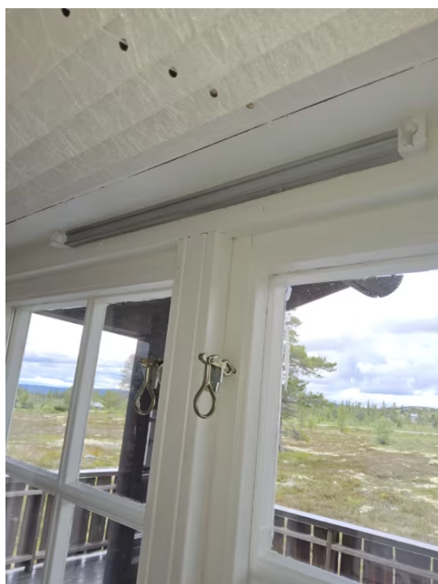
Bilde viser spalteventil i vindu.
