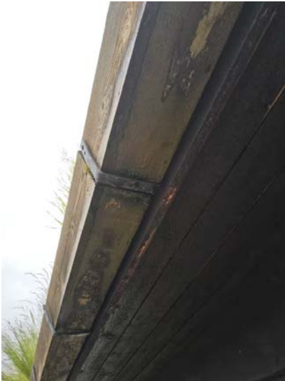
Bilde viser takrenne.
