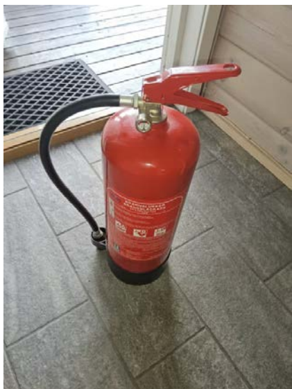
Bilde viser brannslukningsapparat.
