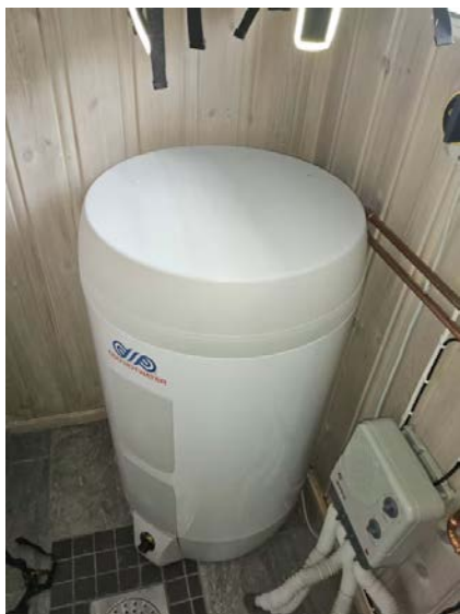
Bilde viser varmtvannsbereider.
