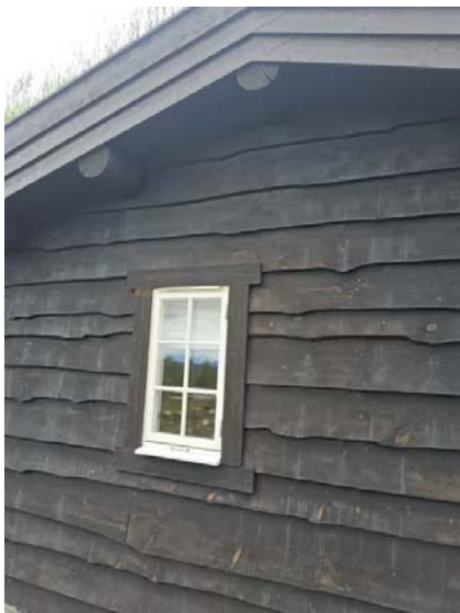
Bilde viser vindu uten vannbrett.
