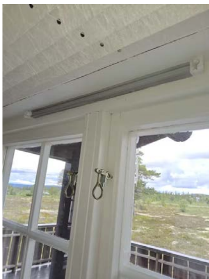
Bilde viser spalteventil i vindu.
