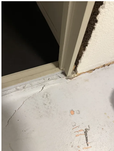
Riss/sprekk i gulvbelegg, lav oppbrett mot terskel.
