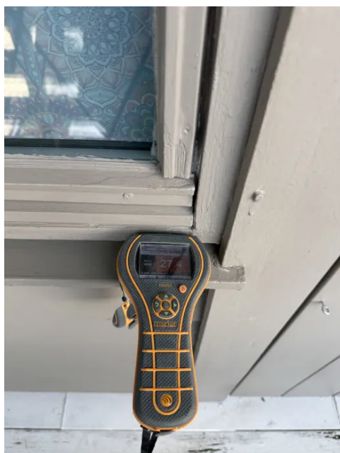
Nedbrytning, fukt registrert i utv. vinduskarm balkong
