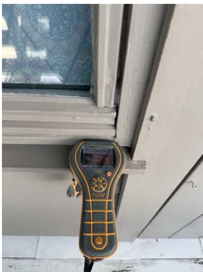
Nedbrytning, fukt registrert i utv. vinduskarm balkong
