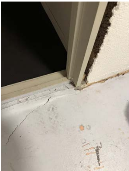
Riss/sprekk i gulvbelegg, lav oppbrett mot terskel.
