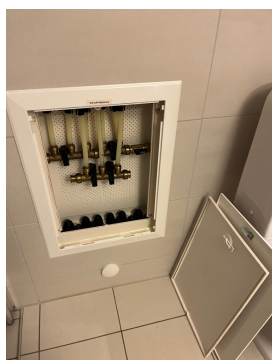
Fordelerskap med stoppekran, funksjonstestet ok.
