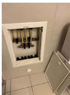
Fordelerskap med stoppekran, funksjonstestet ok.
