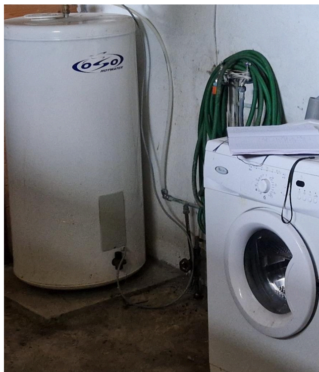
Stengekran i nærheten av varmtvannsberederen.
