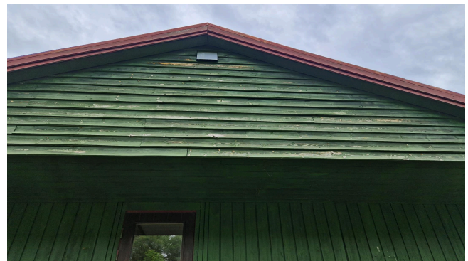
Liggende kledning i gavl. Kraftig avflassing og værslitasje, men konstruksjonen fremstår intakt.
