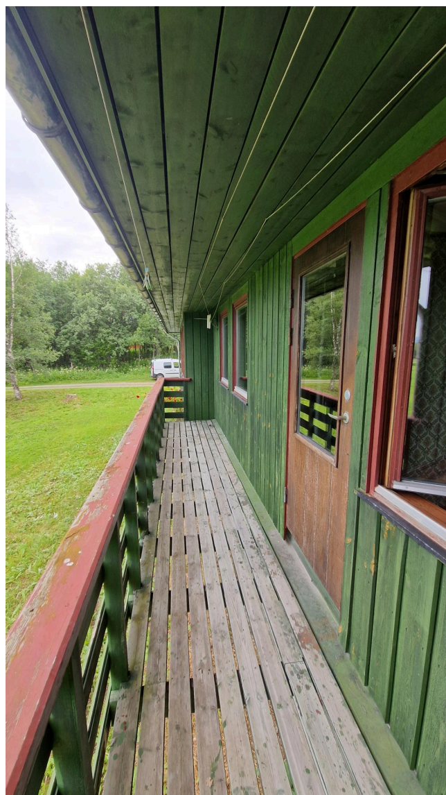
Balkongdør med slitasje på karm og beslag, redusert isoleringsevne. Døra lot seg ikke åpne på befaringsdagen.
