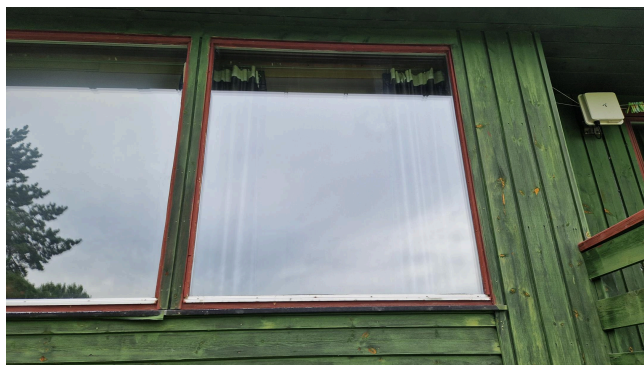
Tolags vindu som bærer preg av værslitasje. Dugg mellom glass var ikke observert på befaringen.
