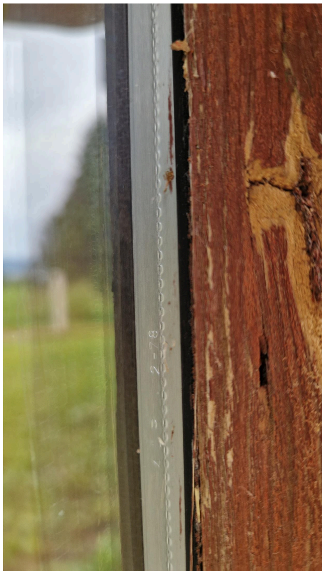
Tolags vindu fra 1978. Slitasje på karm og ramme, ingen opplagte punktering, men høyt varmetap pga. høy U-verdi.
