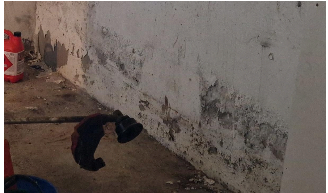
Avflassing av maling og misfarging nederst på vegg i teknisk rom indikerer fuktinnsig.
