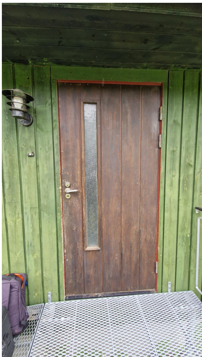
Ytterdør i tre med avflasket maling og eksponert treverk, godt forbi forventet levetid.
