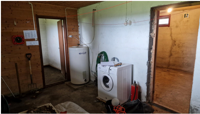
Kjellerbod/teknisk rom med varmtvannsbereder og vaskemaskin.
