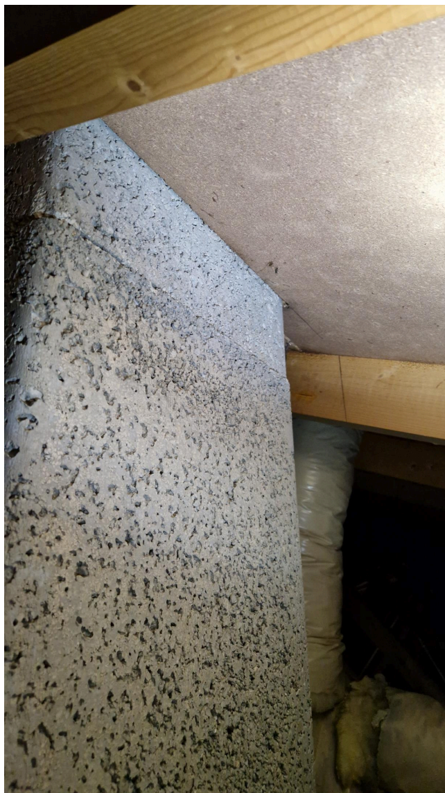
Det var ingen tegn på vanninntrengning rundt pipa.
