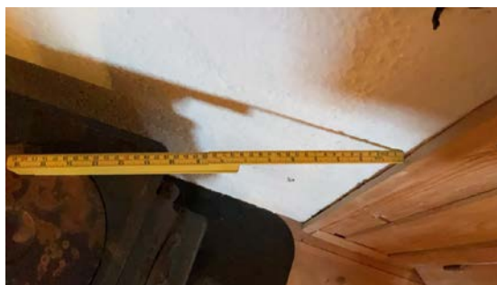
Avstand til brennbart materiale på vegg er for kort
