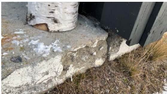
Skade på trinn
