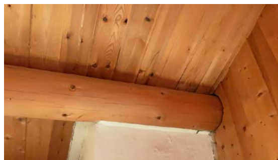
Fukttskjolder i himling rundt pipestamme
