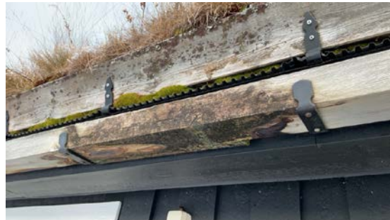
Slitasje på renne, med punktlekkasje i skjøt
