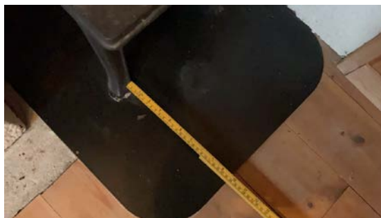
Plate på gulv er for liten ihenhold til krav om avstand til brennbart materiale på gulv
