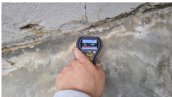
Det ble registrert forhøyde fuktverdier.
