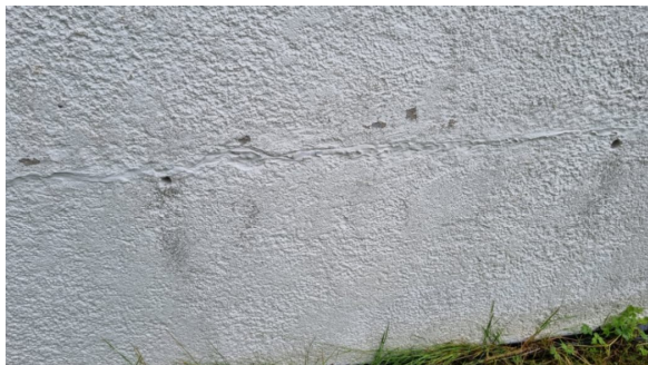
Sprekk i vegg.
