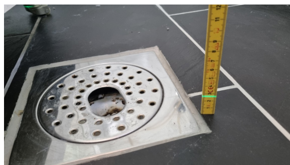
Det ble registrert motfall fra sluk.
