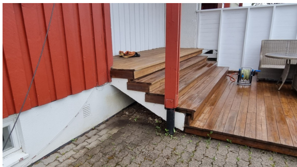
Det er ikke montert rekkverk.
