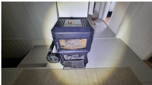
Kombinert ved- og oljeovn i 1. etasje.
