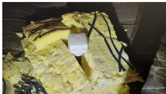
Det er montert vakumsventil på lufteørret.
