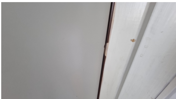
Det er skade på tettepakning.
