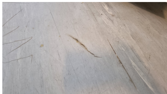
Sprekker i belegg.
