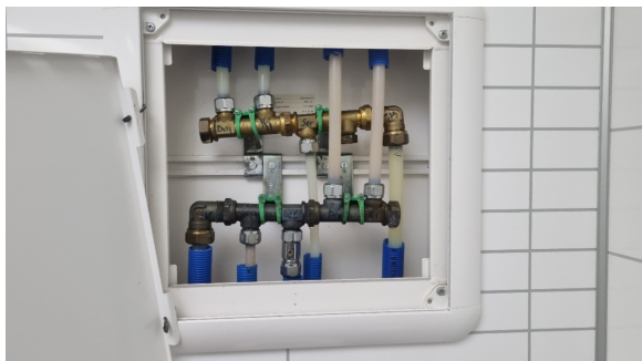
Kontroll av fordelerskap.
