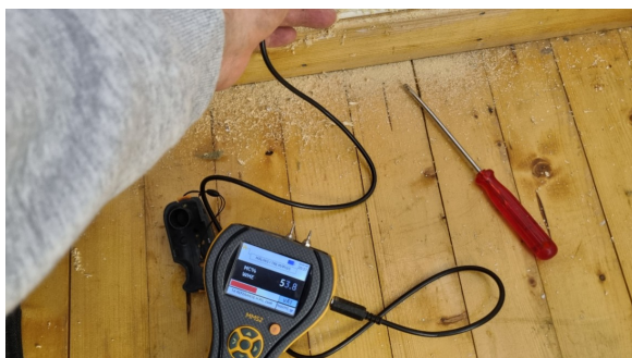
Det ble registrert forhøyde fuktverdier
