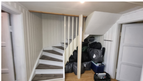
Det mangler håndløper på vegg i trappeløpet.
