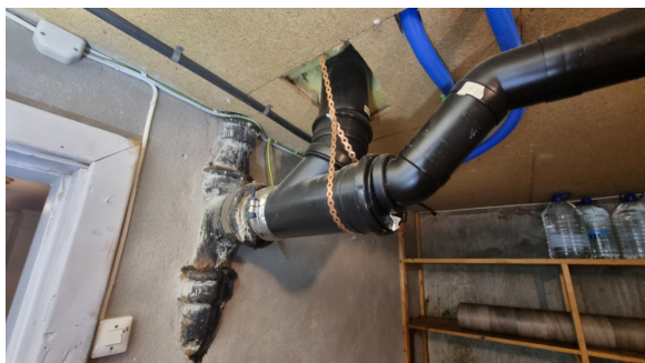
Avløpsrør av plast og soil.
