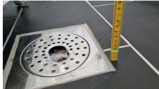
Det ble registrert motfall fra sluk.
