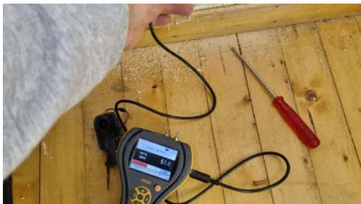
Det ble registrert forhøyd fuktverdier
