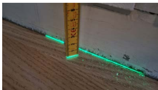
Kontroll av planavvik.
