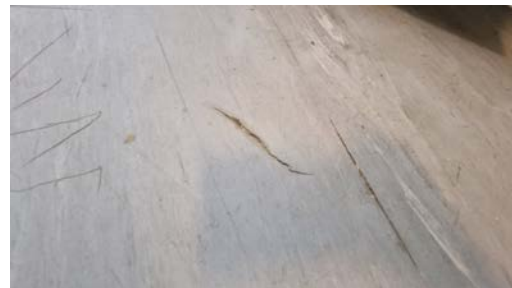
Sprekker i belegg.
