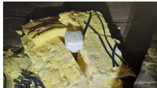
Det er montert vakumsventil på lufterøret.
