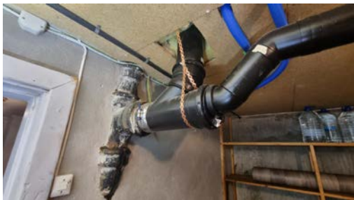
Avløpsrør av plast og soil.
