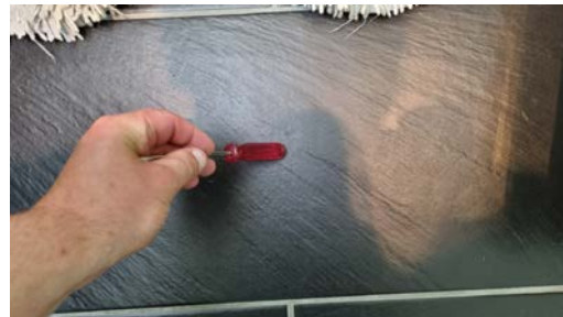
Det er påvist at noen fliser har bom (hulrom under).
