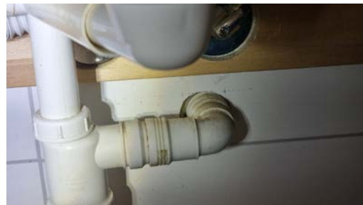
Det er ikke tettet tilfredsstillende rundt rørgjennomføring i vegg.
