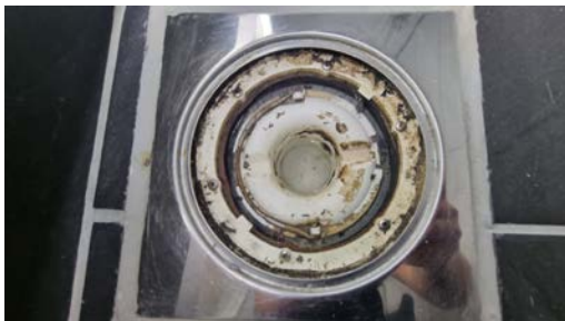
Plastsluk av nyere dato.
