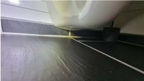
Manglende drensåpning under den innebygde sisternen.
