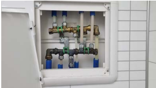
Kontroll av fordelerskap.
