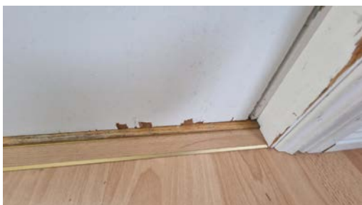
Dørblad og karm har skader, samt at dør subber i terskel.
