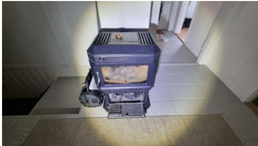
Kombinert ved- og oljeovn i 1. etasje.
