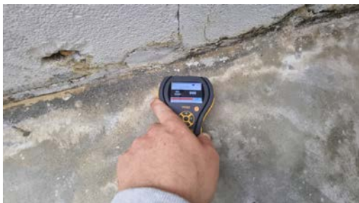
Det ble registrert forhøyde fuktverdier.
