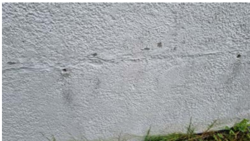
Sprekk i vegg.
