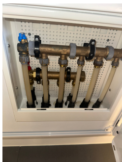
Samleskap med rørkurser og stoppekranner
