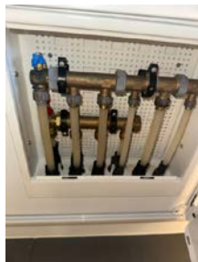
Samleskap med rørkurser og stoppekraner
