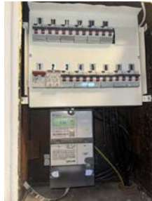
Sikringsskap med automatsikringer.
