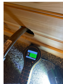
Fuktmåling i utforet vegg i bod i tilbygg.
