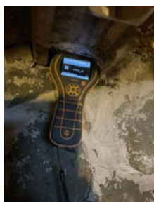
Fuktmåling i etasjeskille eldste del.
