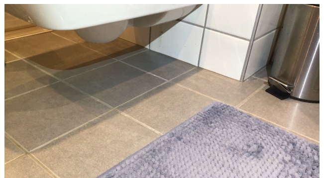
Bildet viser innebygd toalett uten synlig dreneringsløsning.
