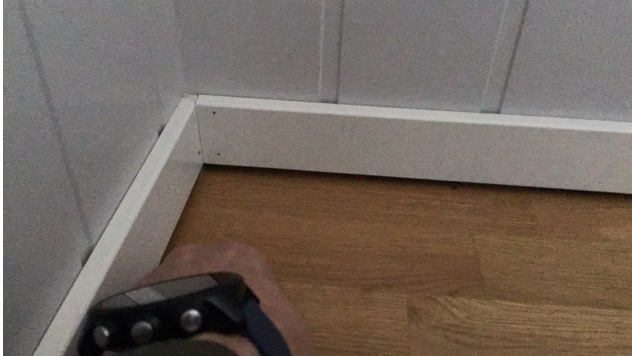
Bildet viser glippe mellom parkettgulv og gulvlist.
