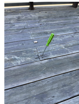
Bildet viser påbegynt råte i terrassebord.
