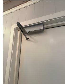
Bildet viser frakoblet dørpumpe.
