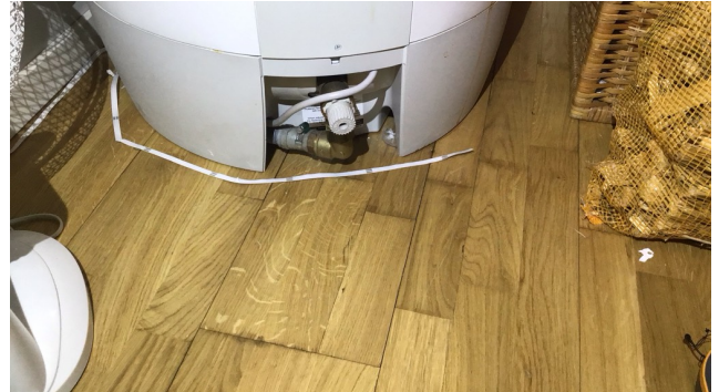
Bildet viser tegn til fuktskade på parkettgulv i boden.
