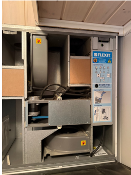
Bildet viser ventilasjonsenhet i boden.
