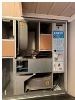
Bildet viser ventilasjonsenhet i boden.
