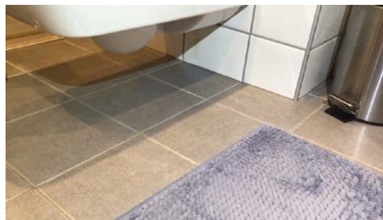
Bildet viser innebygd toalett uten synlig dreneringsløsning.
