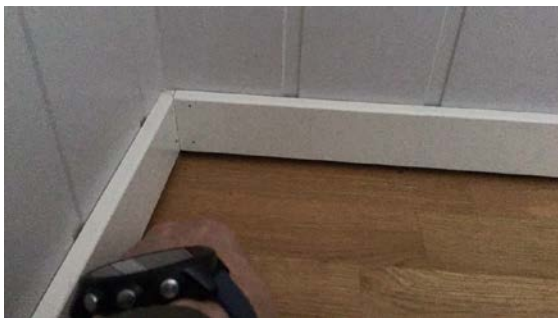
Bildet viser glippe mellom parkettgulv og gulvlist.
