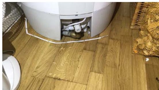
Bildet viser tegn til fuktskade på parkettgulv i boden.
