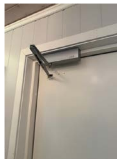
Bildet viser frakoblet dørpumpe.
