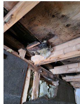
Synlig fukt/råteskader i himling.
