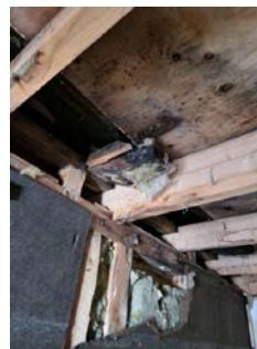
Synlig fukt/råteskader i himling.
