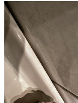
Mangler fuge mellom vask/vegg
