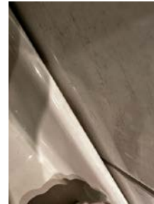
Mangler fuge mellom vask/vegg
