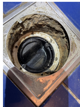
Sluk i dusjen. Banemembran under klemring.
