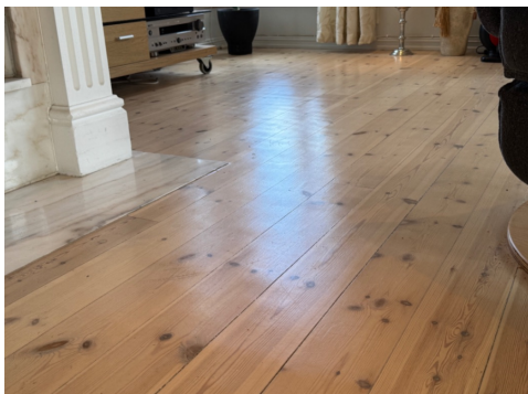
Ujevnheter i furugulv stue og kjøkken
