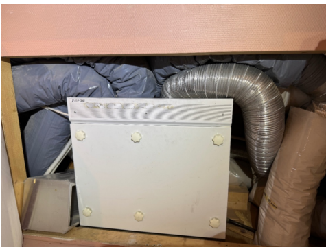
Ventilasjonsaggregat i knekott
