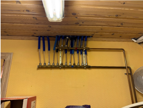
Rør-i-rør system under himling i kjellerbod
