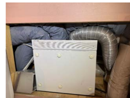
Ventilasjonsaggregat i knekott
