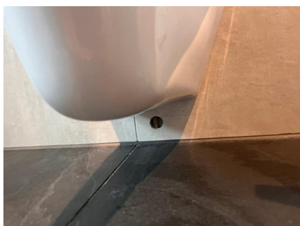
Drensåpning for innbygget toalettsisterne.
