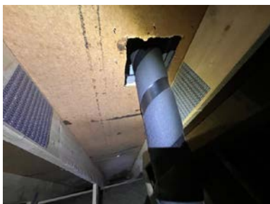
Ikke tettet rundt rør
