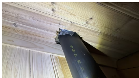
Ikke tilfredsstillende tetting rundt gjennomføring.
