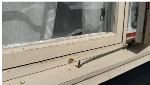
Eksempelbilde på malingsavlass/ oppsprukket kittfals.
