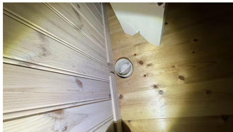
Avtrekk fra dusjrom avsluttet på loft.
