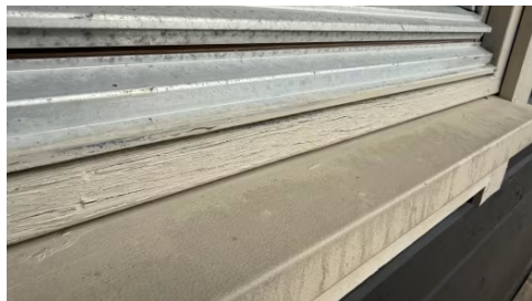
Eksempelbilde på værslitasje.
