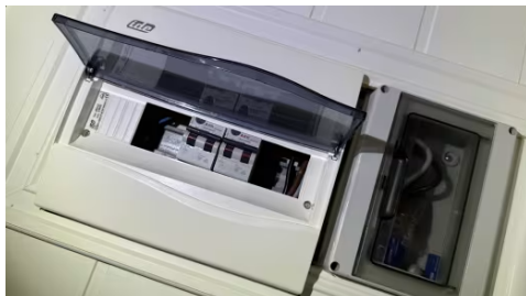
Manglende kursfortegnelse og deksel ved sikringer.
