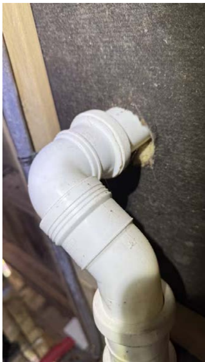
Ikke tilfredsstillende tetting rundt rørføring i gulv under hytta.
