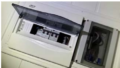
Manglende kursfortegnelse og deksel ved sikringer.
