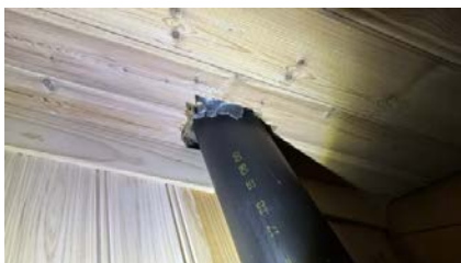
Ikke tilfredsstillende tetting rundt gjennomføring.
