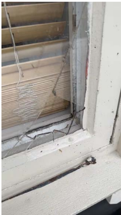
Knust glass i vindu til dusjrom.
