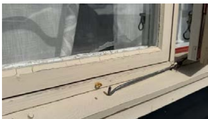
Eksempelbilde på malingsavflass/ oppsprukket kittfals.
