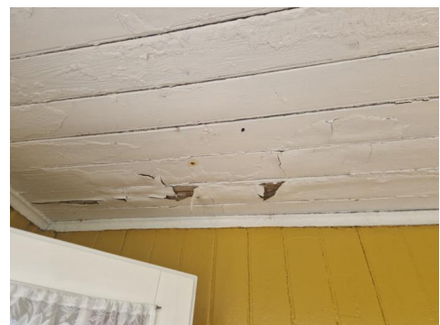
Fuktskade i himling svalegang.
