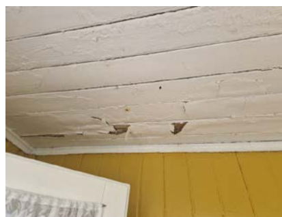
Fuktskade i himling svalegang.
