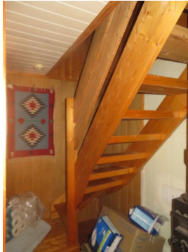
Trapp til loftsplan ses uten barnesikringer i trinn samt manglende håndreke på vegg.
