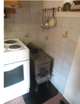
Merk vedovn plassert mellom komfyr og brannmur.
