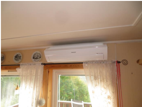
Innvendig aggregatdel på luft til luft varmepumpen.
