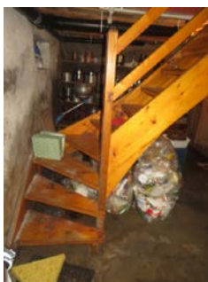
Trapp til kjeller med manglende rekkverk og barnesikringer.
