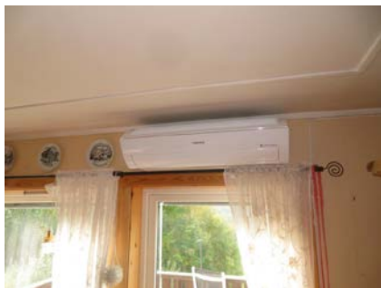
Innvendig aggregatdel på luft til luft varmepumpen.
