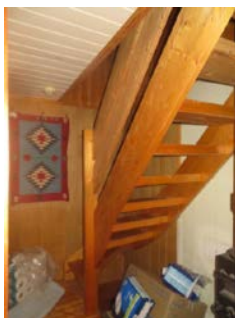
Trapp til loftsplan ses uten barnesikringer i trinn samt manglende håndreke på vegg.
