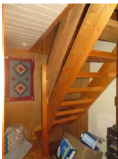
Trapp til loftsplan ses uten bernesikringer i trinn samt manglende håndreke på vegg.
