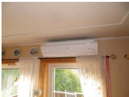
Innvendig aggregatdel på luft til luft varmepumpen.
