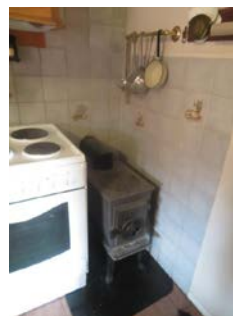
Merk vedovn plassert mellom komfyr og brannmur.
