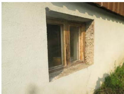
Enklere doble vinduer i kjeller.
