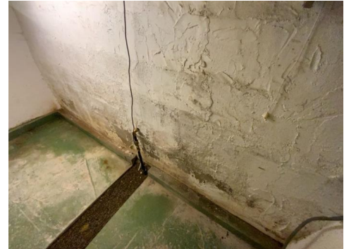
Overflater generelt bør utbedres.
