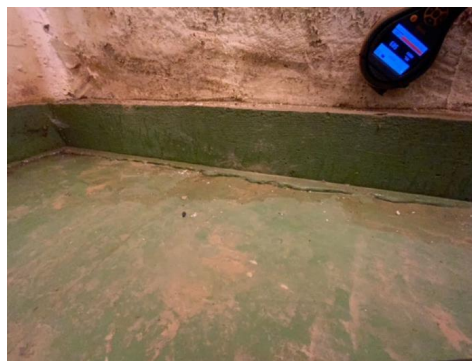
Påvist variable fuktverdier på nedre del av grunnmur.
