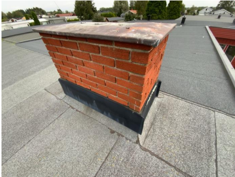
Kontroll rundt pipebeslag.
